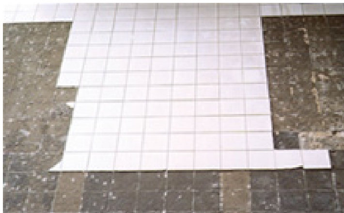
Figura 10 - Destacamento do Revestimento Cerâmico
