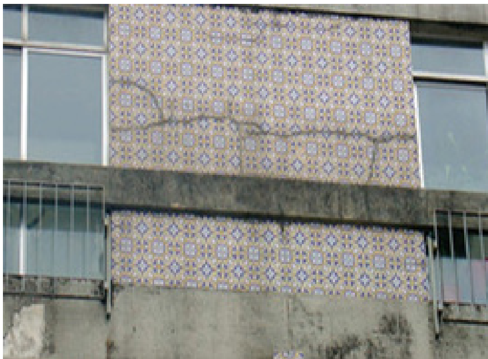
Figura 5 - Fissura de Fachada
